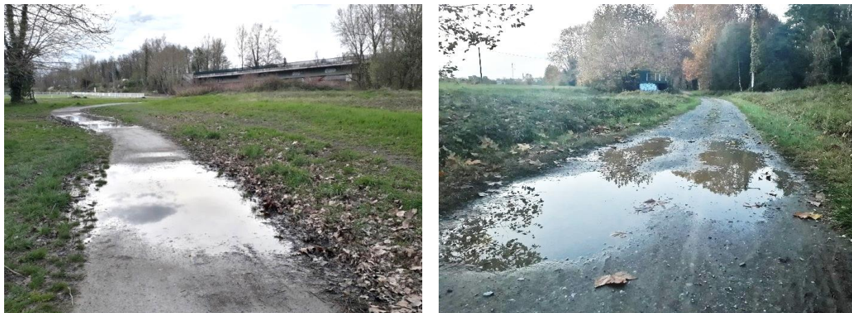
Figure 25 – Mazères-Lezons : accumulations d'eau après un épisode pluvieux
