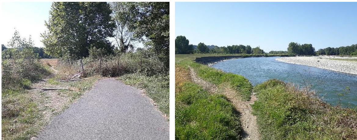
Figure 19 – Interruption d'aménagement à Arbus suite à érosion des berges du gave
