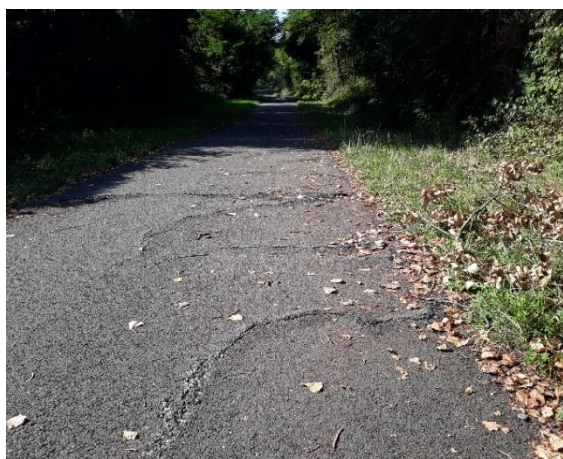
Figure 16 - Bitume soulevé à Artiguelouve
